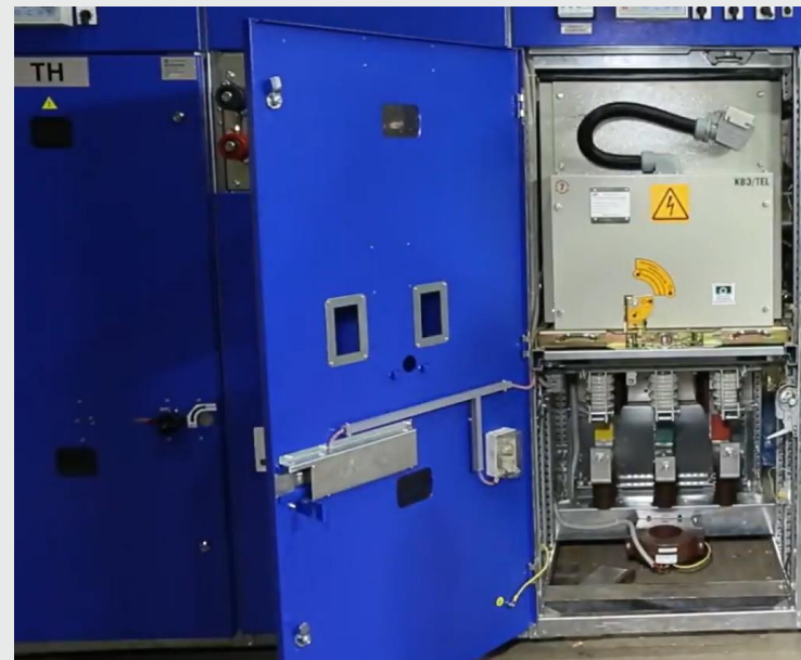
Лишь двухточечный замок и две дверные петли удерживают дверь в закрытом положении
